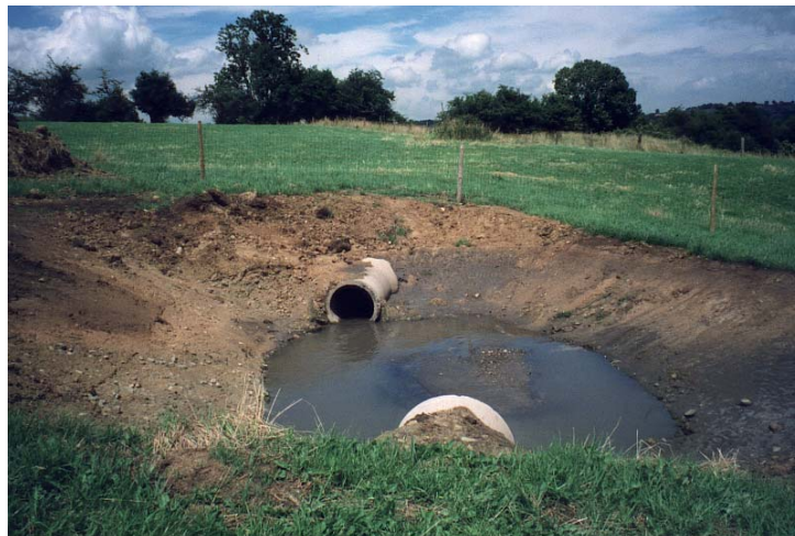
Figure 10. Rupture du collecteur d'égouttage traversant le site de Manaihan (Battice) suite à la réactivation du glissement consécutive aux pluies intenses des 13 et 14 septembre 1998 (photographie JC Schyns 1998).
