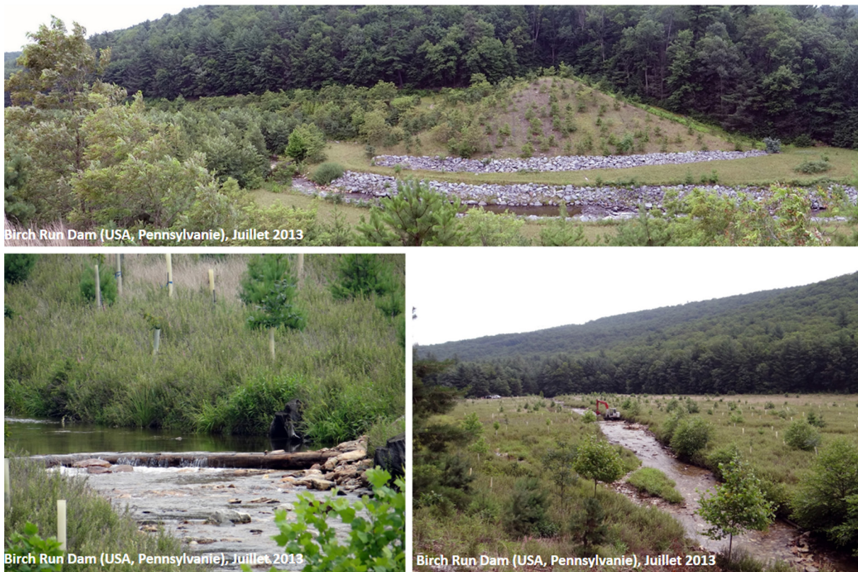
Figure 7. Site du Birch Run Dam sur la Conococheague Creek (Etats-Unis, PA) : arasement du barrage (en haut vue de l'ancien ouvrage depuis la rive droite) et reconfiguration de la rivière et de la plaine alluviale (vue depuis l'aval, en bas à droite et à gauche) : enrochements transversaux, création de 32 seuils artificiels en pierres et troncs immergés en V, plantations en aval et amont de l'ouvrage supprimé sous forme d'une ripisylve et d'une opération de boisement du fond de vallée
