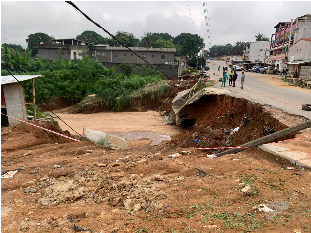
Photo 2. Destruction d'un canal de drainage majeur de la commune suite aux orages à Bingerville. Crédits : Habab Kassoum Traoré, 22 juin 2022
