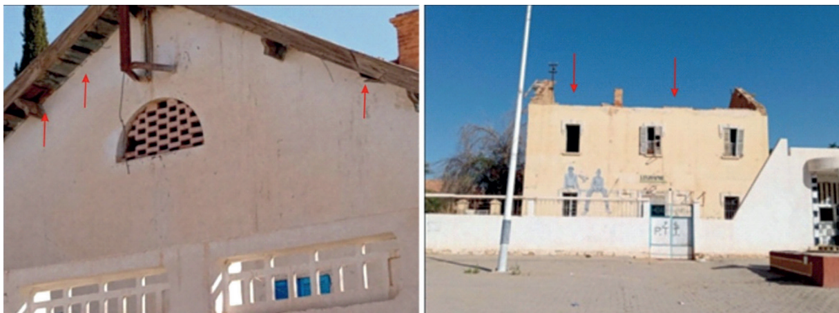
Figures 14-15. Exemples de constructions endommagées à El-Filej (à gauche une habitation à toiture corrodée; à droite le bureau de poste à plafond délabré) (Photographie de l'auteur, juin 2022)
