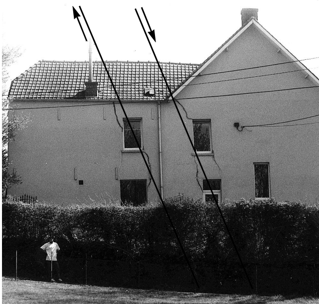
Photo 1. Rue du Renard. Fractured house — Rue du Renard. Maison lézardée.
